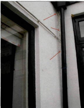
Foto 10: Scheurvorming aansluiting achtergevel-uitbouw nr. 42.
