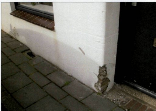
Foto 4: Losgekomen stucwerk nabij de voordeur van nr. 42.
