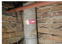
MM04 Monsterlocatie, de buis gaat in de koker tot de eerste verdieping naar het toilet.
